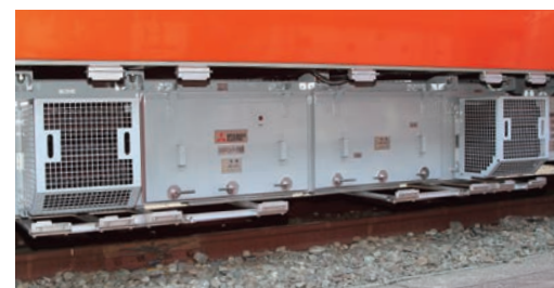
VVVFインバータ制御装置
